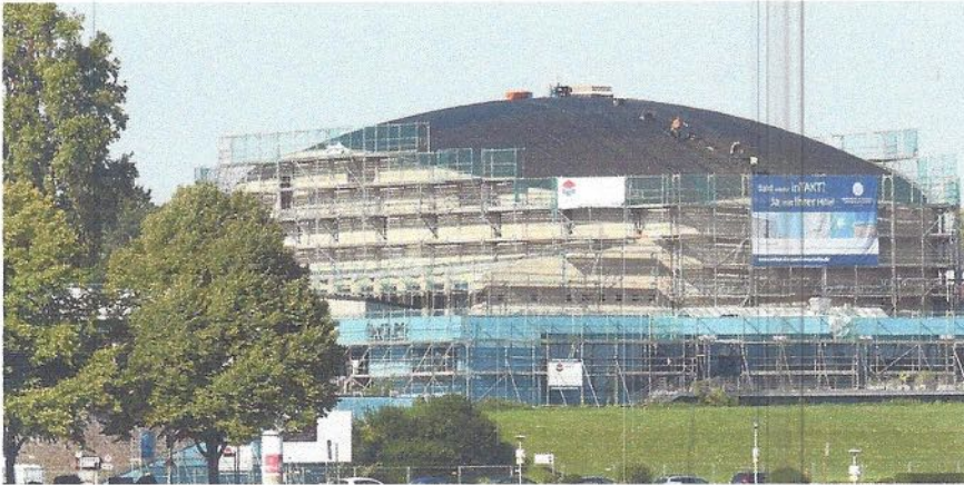
Bei der Sanierung der Beethovenhalle kommt es zu Verzögerungen. Foto: Schwaiger
